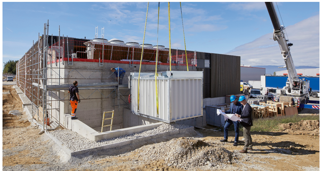
Installation des Eisspeichers (grauer Container)
