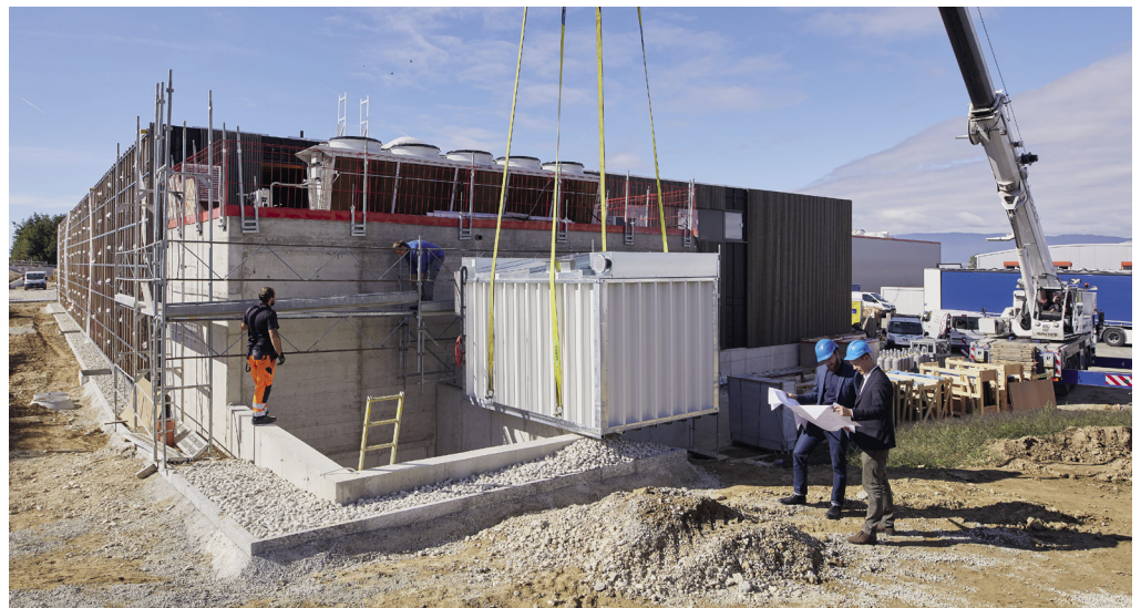
Installation des Eisspeichers (grauer Container)
